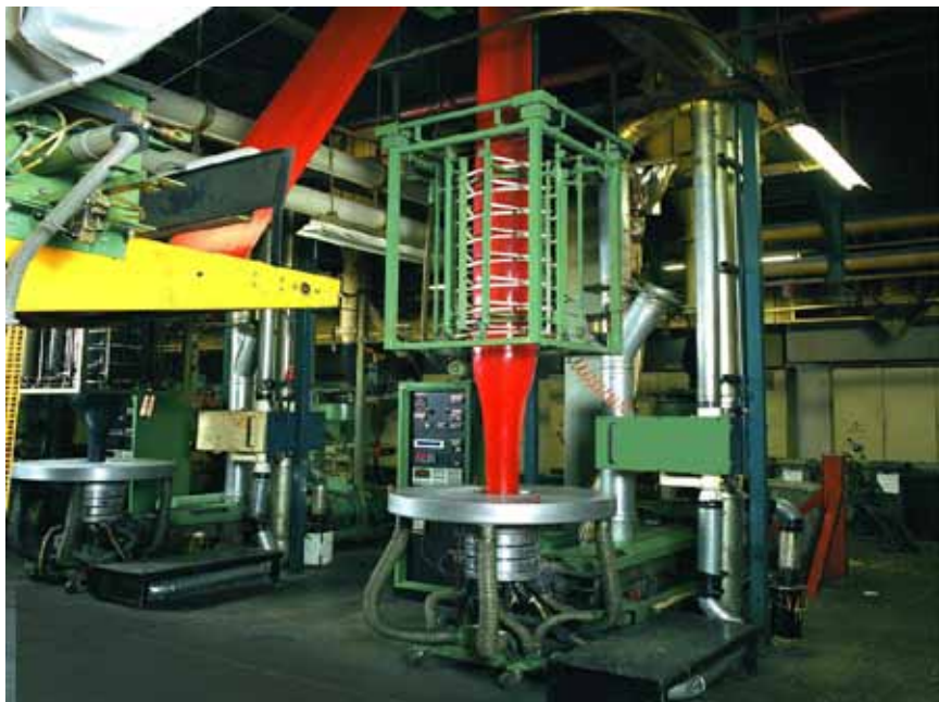
Figuur 17: Folieblaasinstallatie (Foto: Sphere, Hardenberg)
